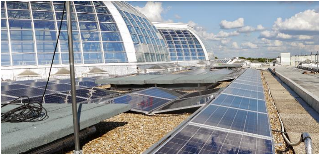
Les panneaux Dualsun sur le toit du siège de Bouygues Construction
